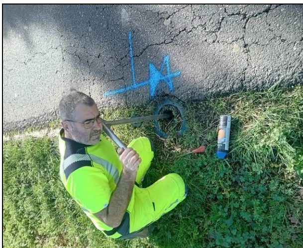
SAMADET - Ecoute de vanne pour la recherche de fuites
